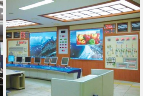
Ilsan Kojenerasyon 2 Elektrik Santrali S / T ana kontrol sistemi ('13)
